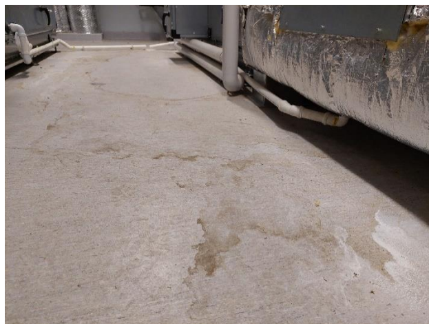
Yleiskuva ilmanvaihtokoneen lattiasta, jossa vanhoja vuotojälkiä.
