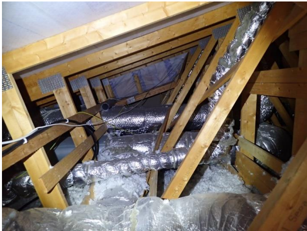
Yleiskuva IV-kanavistojen asennuksista yläpohjassa.
