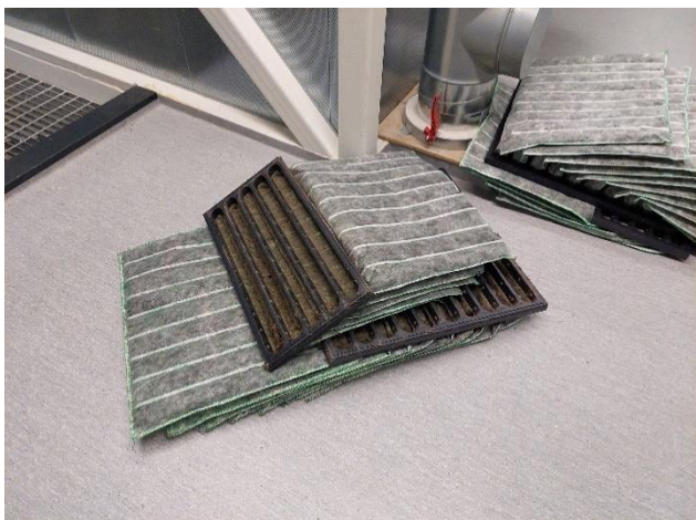
Yleiskuva ilmanvaihtokonehuoneesta, jossa on vanhoja suodattimia.
