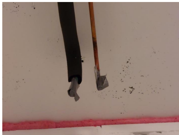
Puutteellinen tulppaus tilassa 0.031
