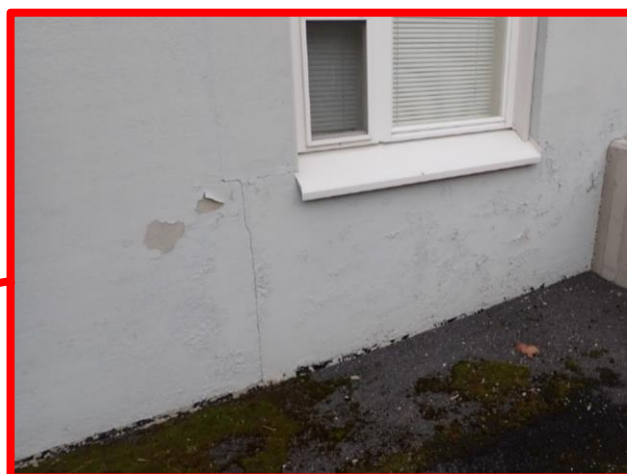
Maalipinnassa on havaittavissa runsaasti maalipinnan hilseilyä.
