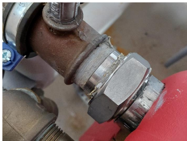
Putkiliitoksessa aktiivinen vuoto
