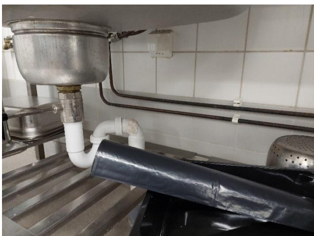
Yleiskuvia vesi- ja viemärikalusteista ja putkiasennuksista
