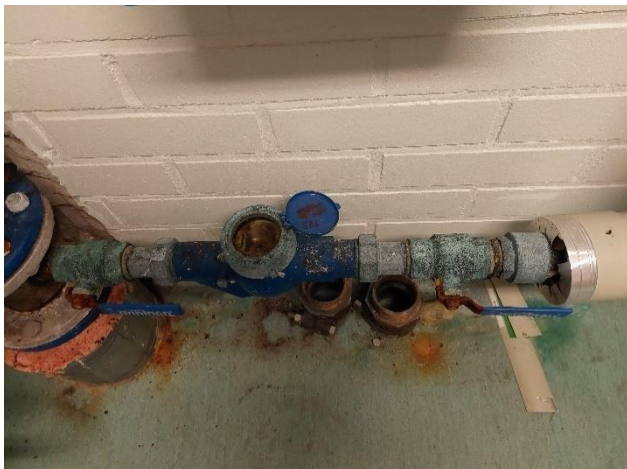
Sprinklerikeskuksessa sijaitsevassa vesimittarissa ja sulkuventtiileissä korroosioauriota.
