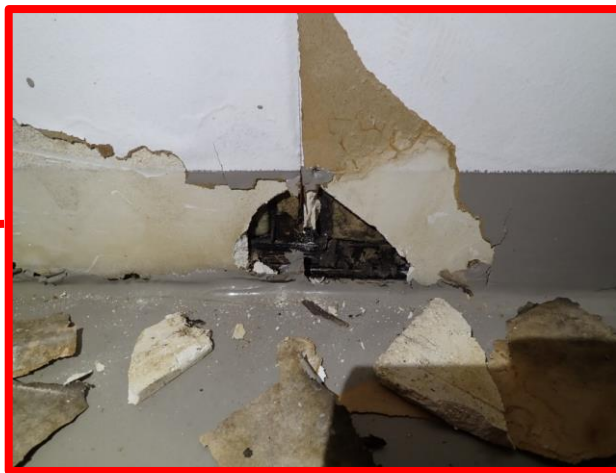
Seinärakenteen alaohjauspuu on tummunut.
