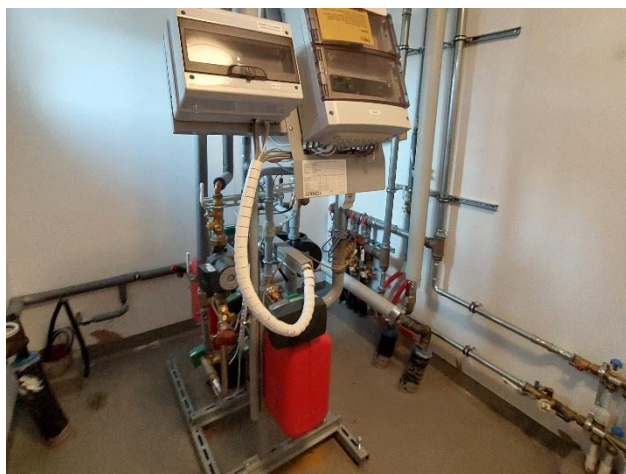
Yleiskuvat lämmön alajakokeskuksesta.
