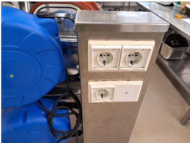
Keittiössä rikkoutuneita IP34-pistorasioita.
