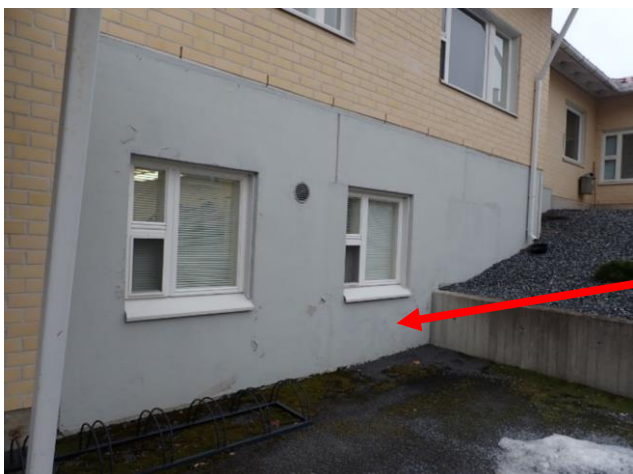
Paikallisesti betonirakenteiseen ulkoseinään kohdistuu kosteusrasitusta.
