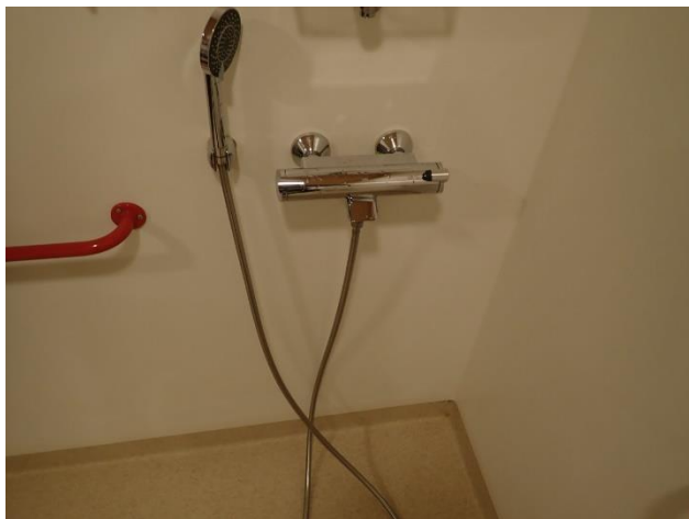
Yleiskuvia vesi- ja viemärikalusteista, ja putkiasennuksista.
