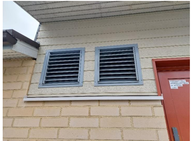
Yleiskuva IV-konehuoneen ulkoilmasäleiköistä.
